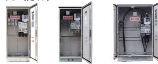
銅帯母線 UAS 盤 銅帯母線 UGS 盤 直接引込 UGS 盤
